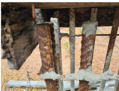
FOTO 15: ARMADURA DE ESPERA DAS FUNDAÇÕES EM OXIDAÇÃO.
