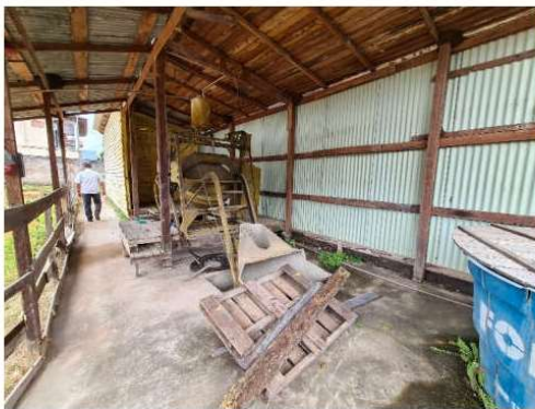
FOTO 09: CENTRAL DE CONCRETO.
