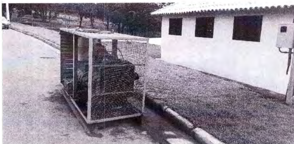
FOTO 14: GERADOR DE ENERGIA PROVISÓRIO PARA ATENDIMENTO AOS PROPRIETÁRIOS.
