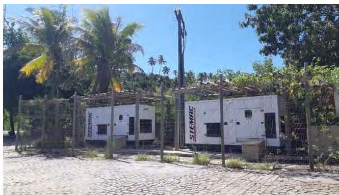
FOTO 58: GERADORES NA ENTRADA
