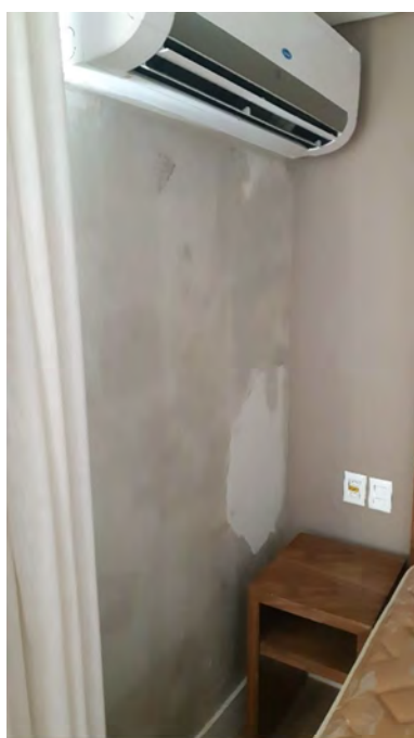
FOTO 45: APTO 172 – REPARO A SER REALIZADO
