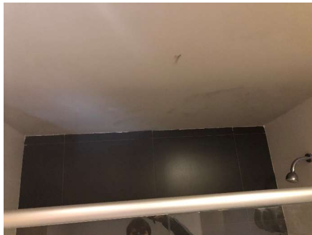
FOTO 74: SUÍTE 402 - INFILTRAÇÃO NO FORRO DO WC
