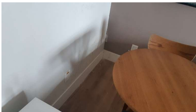
FOTO 55: APTO 177 – REPARO A SER REALIZADO
