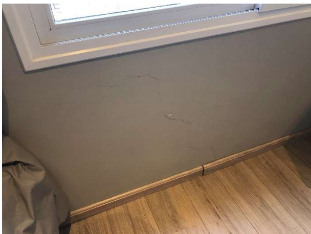
FOTO 57: SUÍTE 321 – TRINCA NA PAREDE
