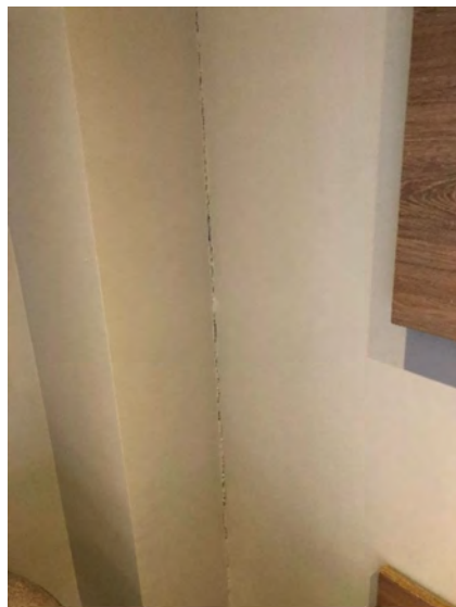
FOTO 46: SUÍTE 221 – TRINCA NA PAREDE
