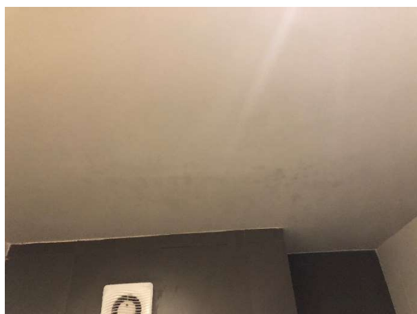
FOTO 36: SUÍTE 121 - INFILTRAÇÃO NO FORRO DO WC
