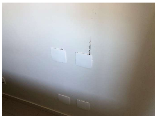
FOTO 42: APTO Nº 1108 - REPARO A SER REALIZADO
