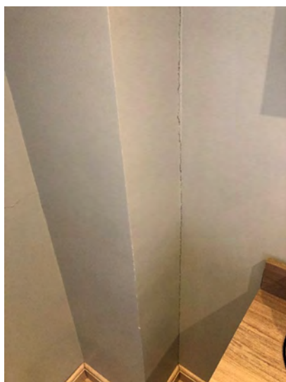
FOTO 59: SUÍTE 321 – TRINCA NA PAREDE
