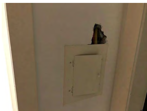
FOTO 18: APTO Nº 1106 – REPARO A SER REALIZADO
