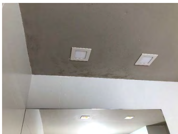
FOTO 42: SUÍTE 135 - INFILTRAÇÃO NO FORRO DO WC
