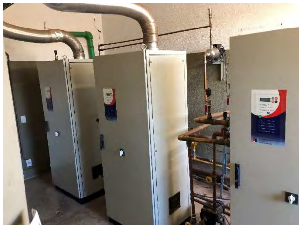
FOTO 127: CENTRAL DE AQUECEDORES
