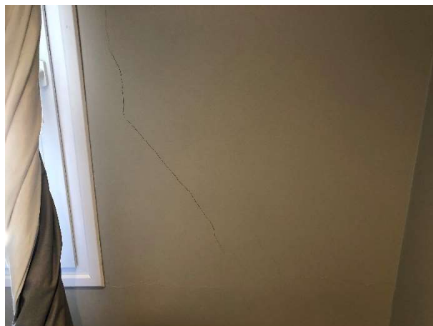
FOTO 58: SUÍTE 321 - TRINCA NA PAREDE
