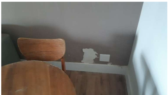
FOTO 31: APTO 165 - DETALHE NA PAREDE
