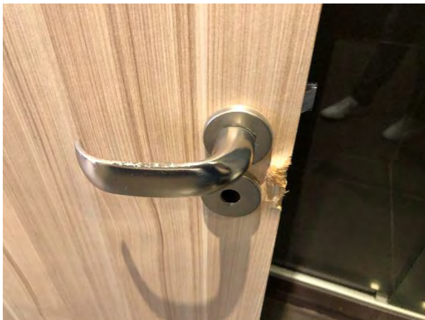
FOTO 73: PORTA DA SUÍTE 402 DANIFICADA
