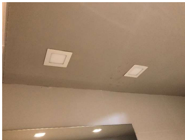
FOTO 62: SUÍTE 321 - INFILTRAÇÃO NO FORRO DO WC
