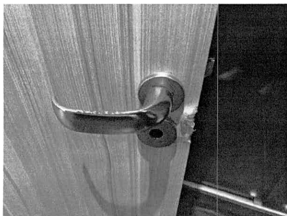
FOTO 73: PORTA DA SUÍTE 402 DANIFICADA
