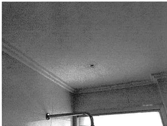
FOTO 14: APTO Nº 1101 – INFILTRAÇÃO NO FORRO DO WC
