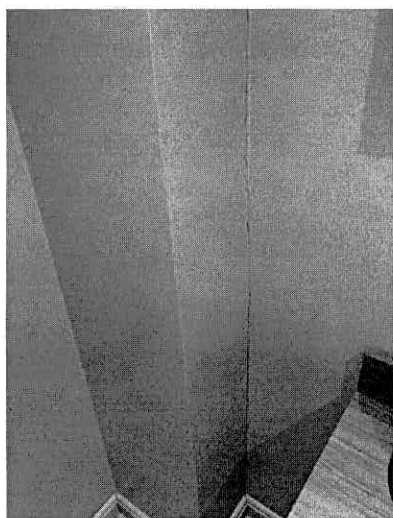
FOTO 59: SUÍTE 321 – TRINCA NA PAREDE
