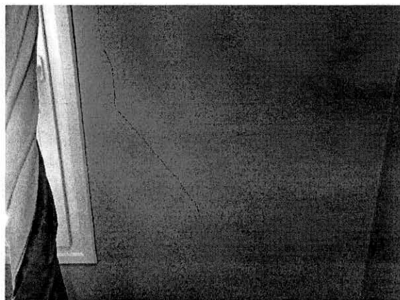
FOTO 58: SUÍTE 321 - TRINCA NA PAREDE
