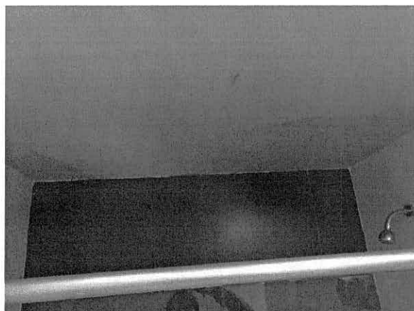
FOTO 74: SUÍTE 402 - INFILTRAÇÃO NO FORRO DO WC
