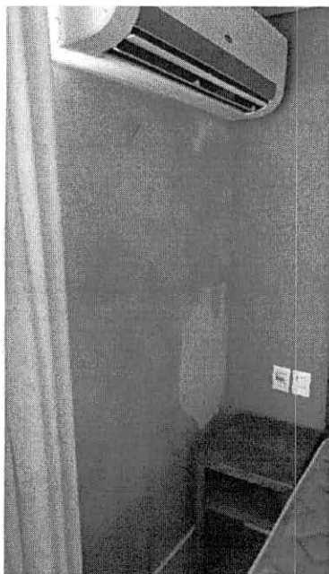
FOTO 45: APTO 172 – REPARO A SER REALIZADO
