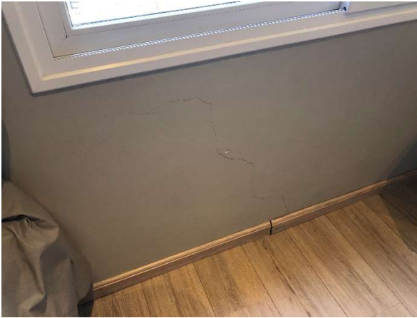
FOTO 57: SUÍTE 321 – TRINCA NA PAREDE
