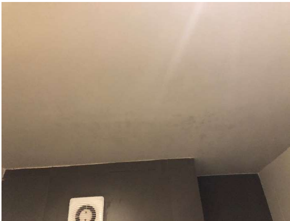
FOTO 36: SUÍTE 121 - INFILTRAÇÃO NO FORRO DO WC
