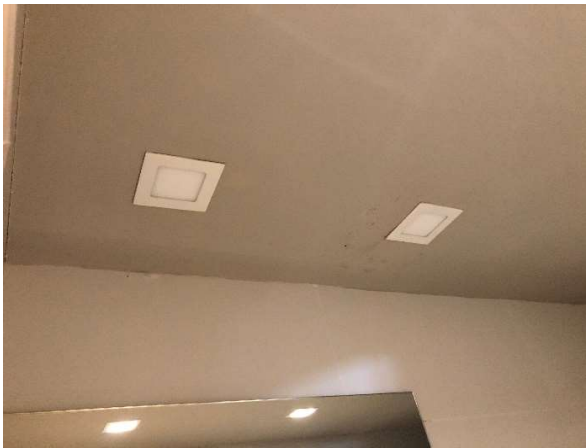
FOTO 62: SUÍTE 321 - INFILTRAÇÃO NO FORRO DO WC
