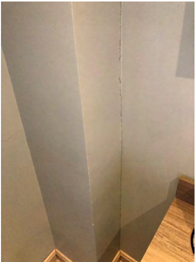
FOTO 59: SUÍTE 321 – TRINCA NA PAREDE
