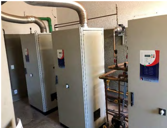
FOTO 127: CENTRAL DE AQUECEDORES
