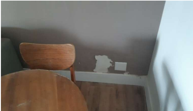
FOTO 31: APTO 165 - DETALHE NA PAREDE
