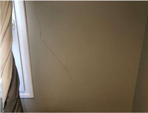
FOTO 58: SUÍTE 321 - TRINCA NA PAREDE
