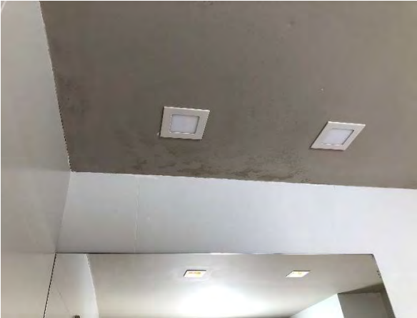
FOTO 42: SUÍTE 135 - INFILTRAÇÃO NO FORRO DO WC
