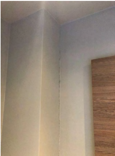
FOTO 60: SUÍTE 321 – TRINCA NA PAREDE
