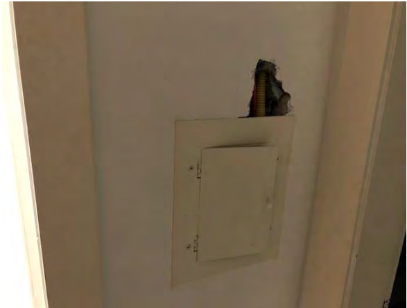
FOTO 18: APTO Nº 1106 – REPARO A SER REALIZADO
