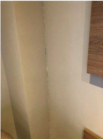
FOTO 46: SUÍTE 221 – TRINCA NA PAREDE
