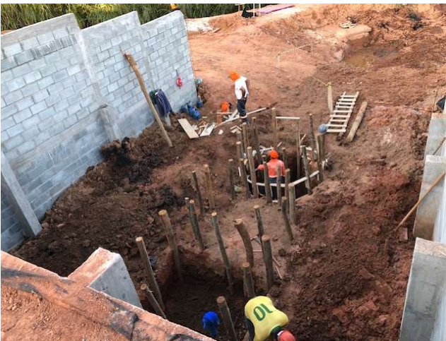
FOTO 27: ESTAÇÃO ELEVATÓRIA DE ESGOTO 1.
