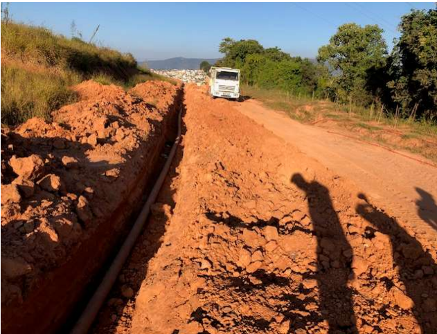
FOTO 19: RUA 02 – REDE DE ÁGUA.
