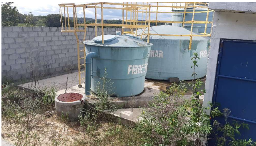
FOTO 10: ESTAÇÃO COMPACTA DE TRATAMENTO DE ESGOTO SANITÁRIO.
