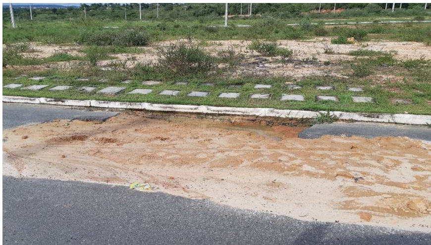
FOTO 37: RUA C4, NECESSITANDO DE RESTAURAÇÃO.
