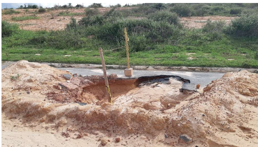
FOTO 24: RUA C7, NECESSITANDO DE RESTAURAÇÃO.
