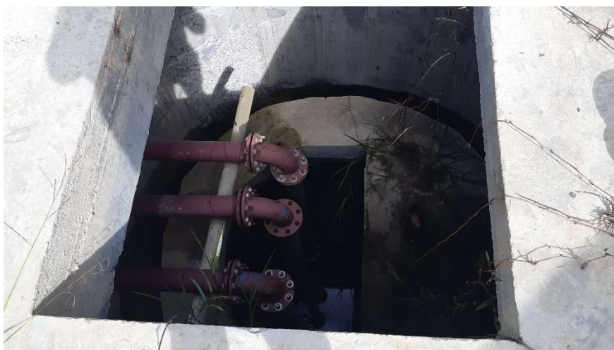
FOTO 06: ESTAÇÃO ELEVATÓRIA DE ESGOTO BRUTO.
