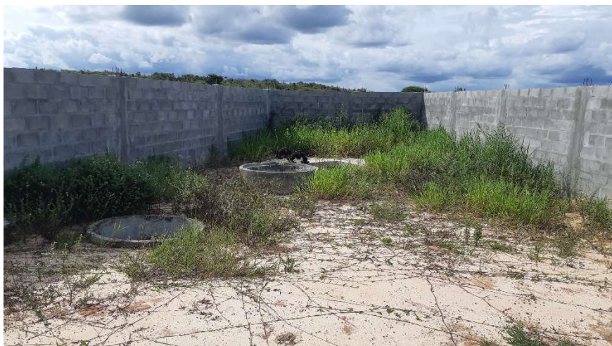
FOTO 05: ESTAÇÃO ELEVATÓRIA DE ESGOTO BRUTO.
