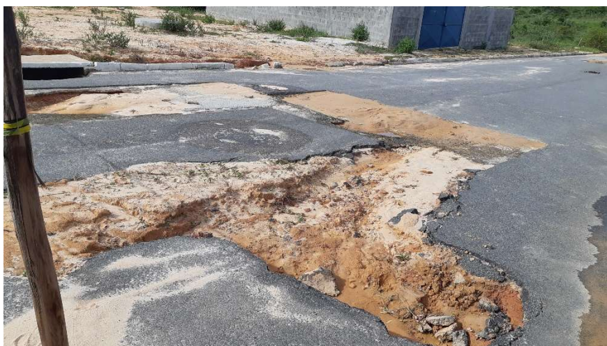
FOTO 21: RUA B, NECESSITANDO DE RESTAURAÇÃO.
