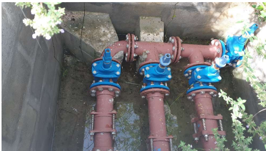
FOTO 07: ESTAÇÃO ELEVATÓRIA DE ESGOTO BRUTO.
