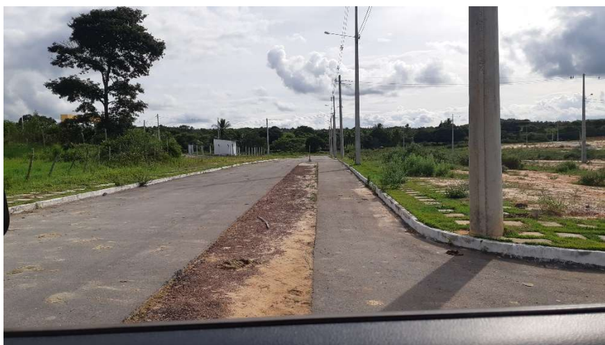
FOTO 27: RUA 1 EIXO 2, NECESSITANDO DE RESTAURAÇÃO.
