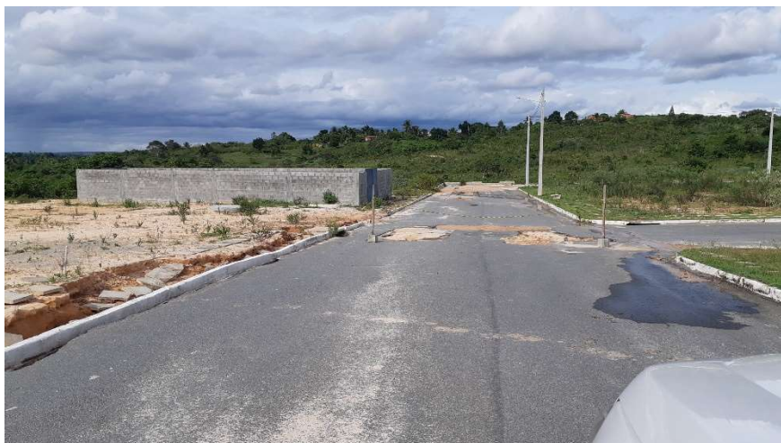
FOTO 19: RUA B, NECESSITANDO DE RESTAURAÇÃO.
