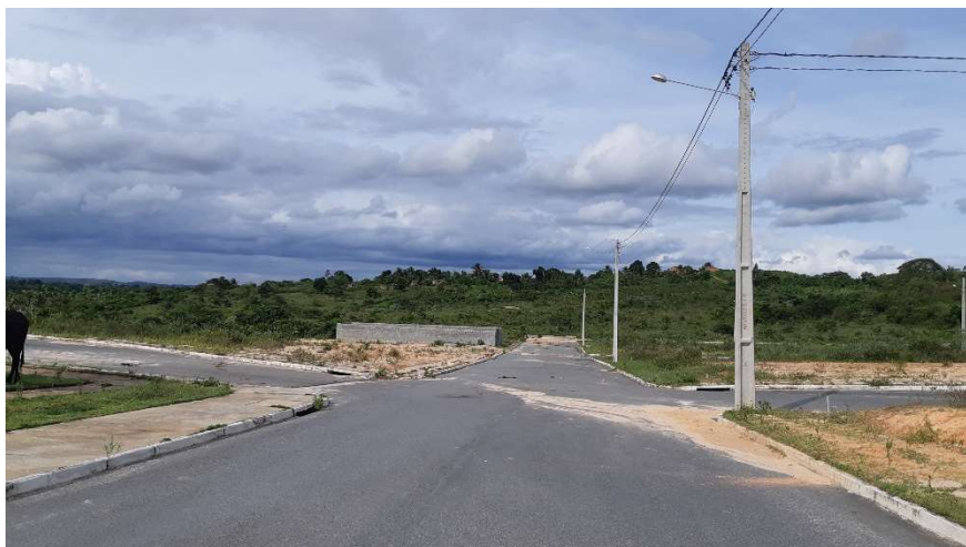
FOTO 20: RUA B, NECESSITANDO DE RESTAURAÇÃO.
