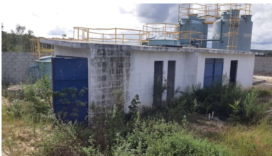
FOTO 09: ESTAÇÃO COMPACTA DE TRATAMENTO DE ESGOTO SANITÁRIO.
