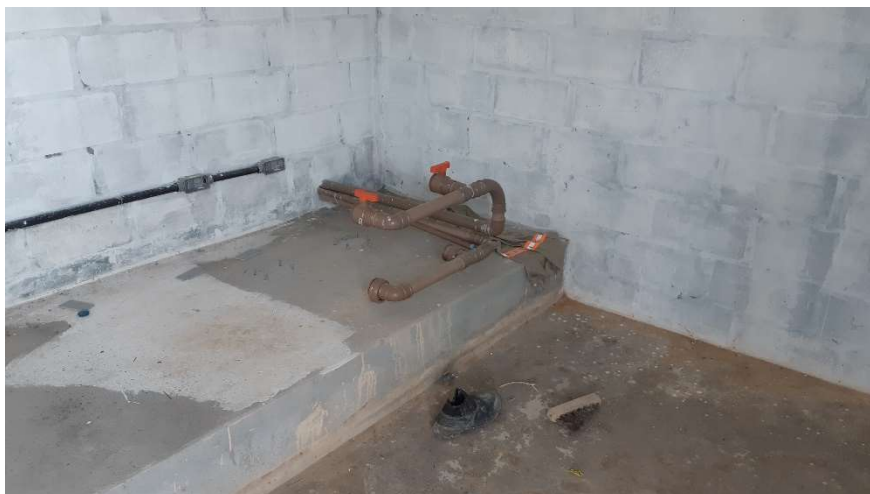
FOTO 13: ETE COMPACTA SEM BOMBAS ESTACIONÁRIAS.
