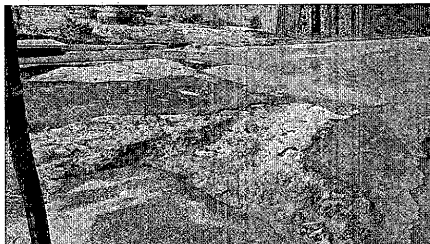
FOTO 21: RUA B, NECESSITANDO DE RESTAURAÇÃO.
