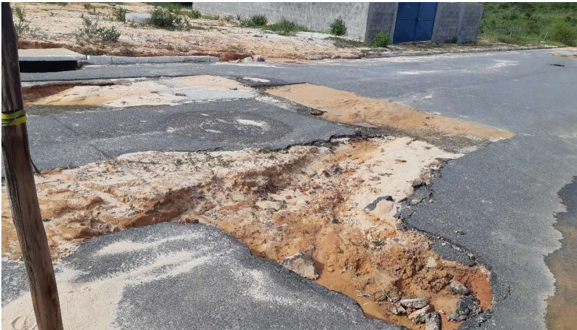
FOTO 21: RUA B, NECESSITANDO DE RESTAURAÇÃO.
