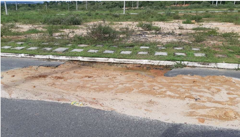
FOTO 37: RUA C4, NECESSITANDO DE RESTAURAÇÃO.
