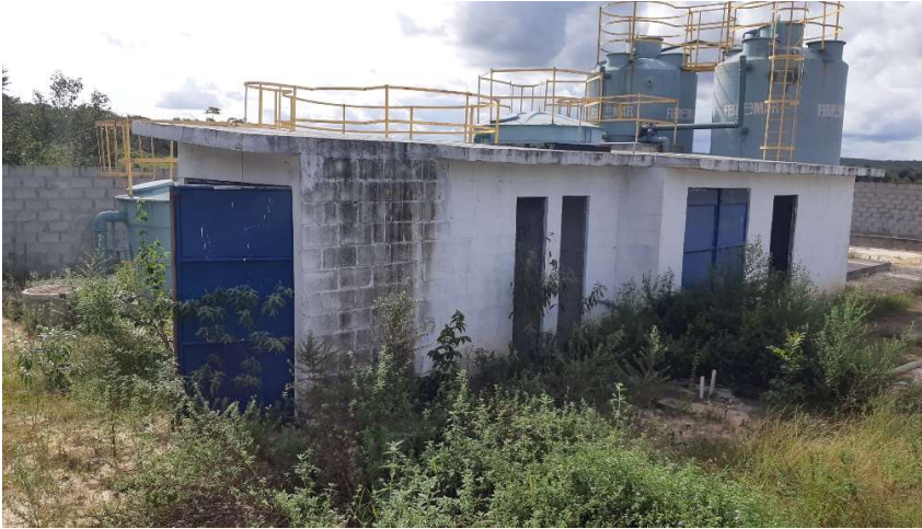
FOTO 09: ESTAÇÃO COMPACTA DE TRATAMENTO DE ESGOTO SANITÁRIO.
