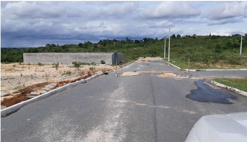
FOTO 19: RUA B, NECESSITANDO DE RESTAURAÇÃO.
