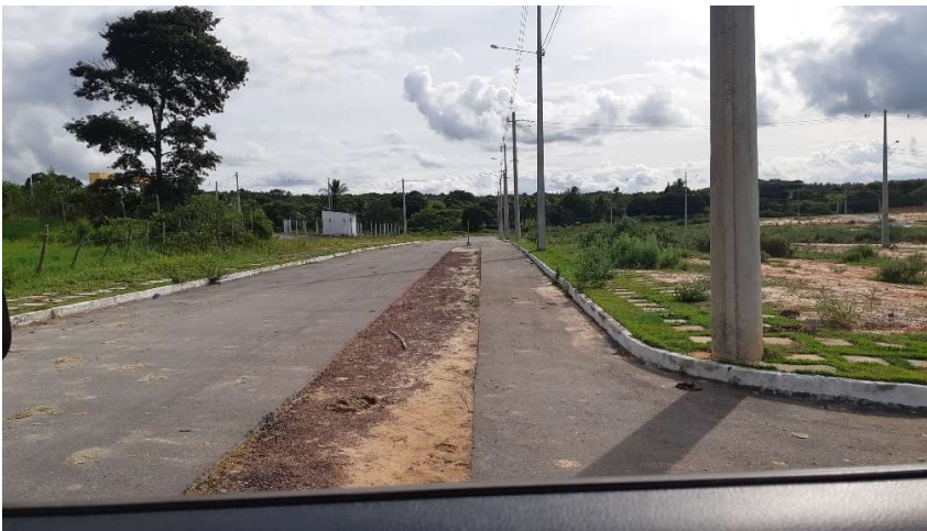
FOTO 27: RUA 1 EIXO 2, NECESSITANDO DE RESTAURAÇÃO.
