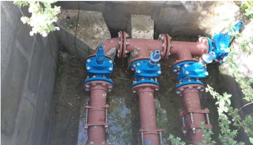
FOTO 07: ESTAÇÃO ELEVATÓRIA DE ESGOTO BRUTO.
