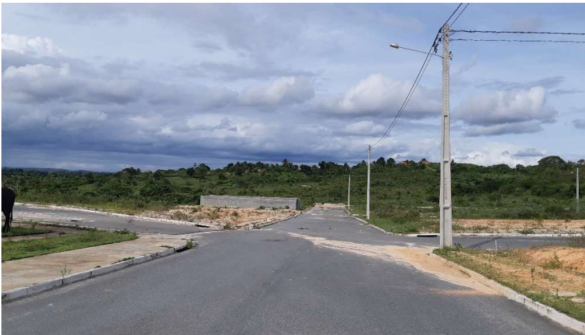
FOTO 20: RUA B, NECESSITANDO DE RESTAURAÇÃO.
