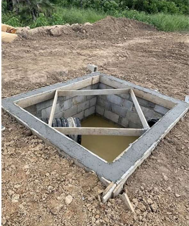
FOTO 40: POÇO DE VISITA DA REDE DE DRENAGEM – FOTO DE FEVEREIRO
