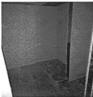
Banheiro 1ºss Bloco D
