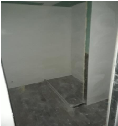
Banheiro 1ºss Bloco D
