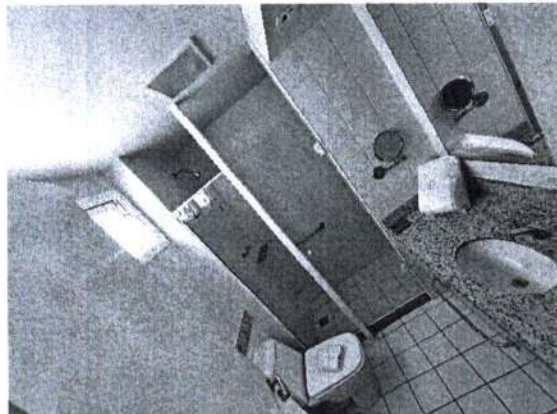
FOTO 20: UNIDADE 1550 – DOBLE A REFORMAR.
