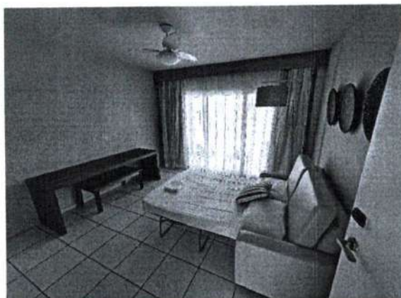
FOTO 17: UNIDADE 1550 –A SER REFORMADA.
