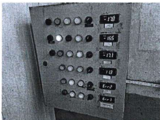
FOTO 52: QUADRO ELÉTRICO NOVO – CÂMARAS FRIA.
