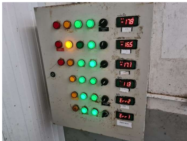
FOTO 52: QUADRO ELÉTRICO NOVO – CÂMARAS FRIA.
