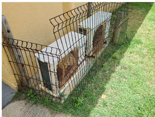
FOTO 16: AR CONDICIONADO A SER SUBSTITUÍDO.
