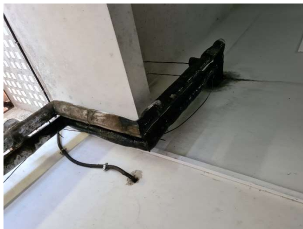
FOTO 54: TUBULAÇÃO FRIGORÍGENA ANTIGA.
