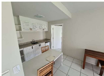
FOTO 18: UNIDADE 1550 –A SER REFORMADA.
