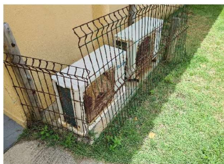
FOTO 16: AR CONDICIONADO A SER SUBSTITUÍDO.
