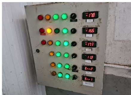
FOTO 52: QUADRO ELÉTRICO NOVO – CÂMARAS FRIA.
