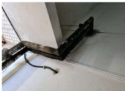
FOTO 54: TUBULAÇÃO FRIGORÍGENA ANTIGA.
