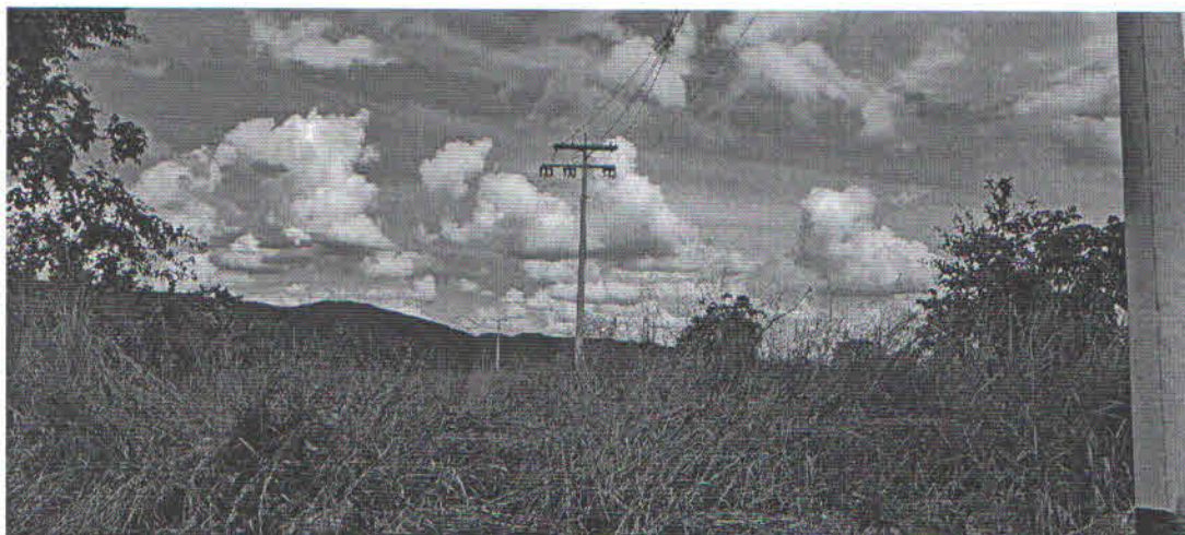
FOTO 07: RAMAL ALIMENTADOR DE ENTRADA DA REDE DE ENERGIA PRESERVADO.
