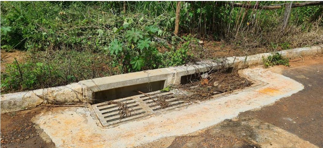
FOTO 13: FALTA LIMPEZA DAS BOCAS DE LOBO.
