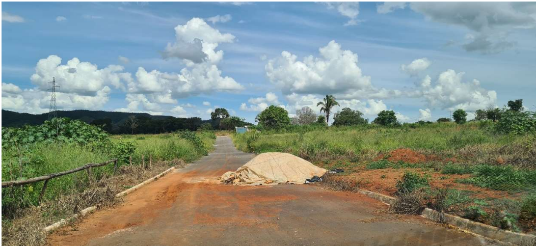
FOTO 12: MATERIAL ESTOCADO INCORRETAMENTE NA RUA.
