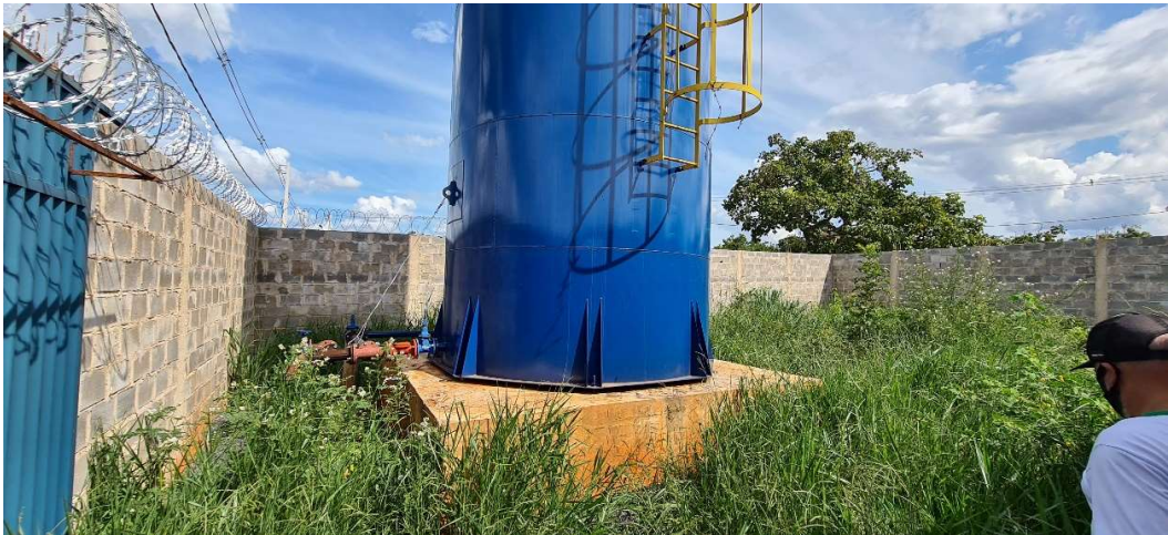
FOTO 16: TERRENO DO RESERVATÓRIO SEM MANUTENÇÃO.
