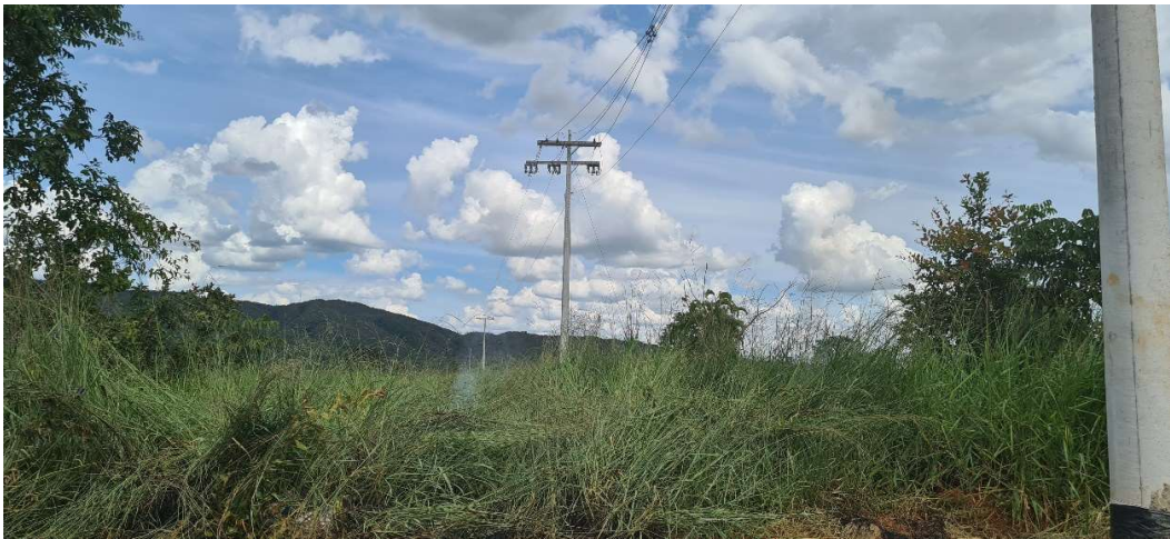
FOTO 07: RAMAL ALIMENTADOR DE ENTRADA DA REDE DE ENERGIA PRESERVADO.
