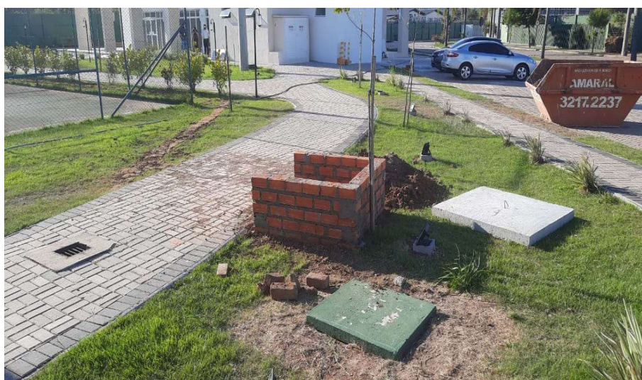
FOTO 06: IRRIGAÇÃO – CASA DE MÁQUINAS AO LADO DE CISTERNA
