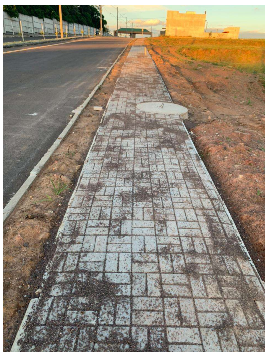
FOTO 16: CALÇADA AVENIDA A
