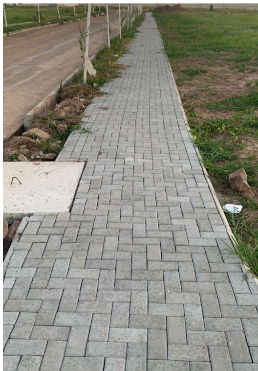
FOTO 17: CALÇADA RUA M
