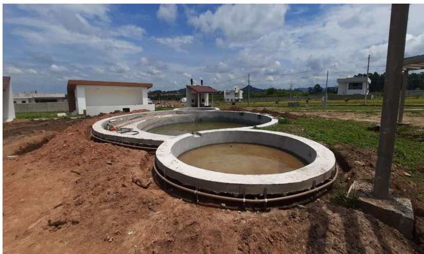
FOTO 04: ÁREA VERDE 4 – PISCINAS – HIDRÁULICA
