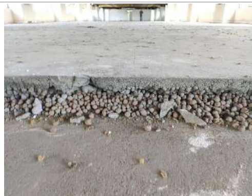
Detalhe do desnível (camada de argila expansiva)
