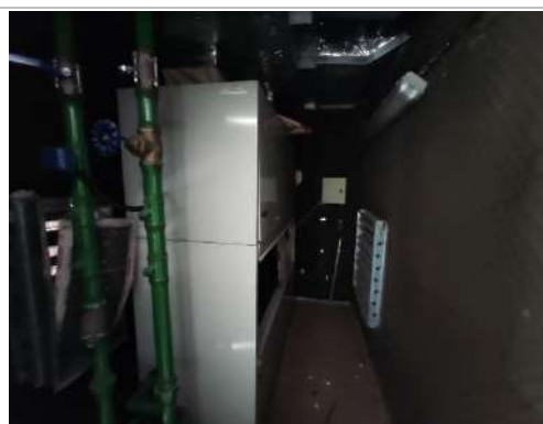
Controle de Ar-condicionado (conjunto 31)
