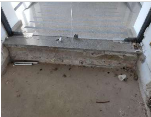
Desnível do piso do conjunto 61
