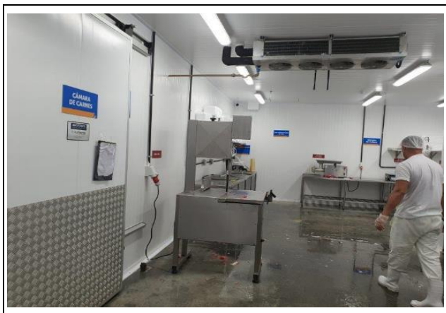
VISTA DA CÂMARA FRIA / AÇOUGUE
