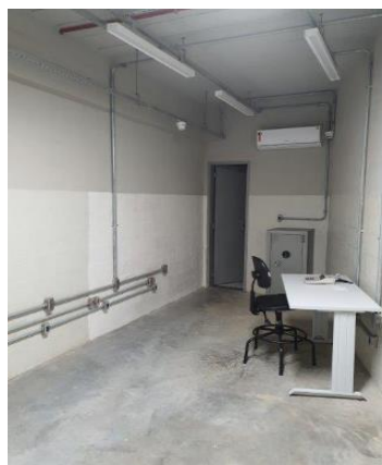
VISTA DA SALA DE MONITORAMENTO
