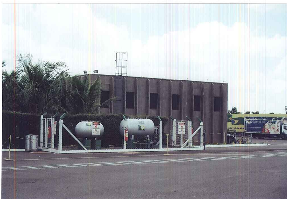
RESERVATÓRIOS DE GÁS, JUNTO AO PRÉDIO DAS OFICINAS
