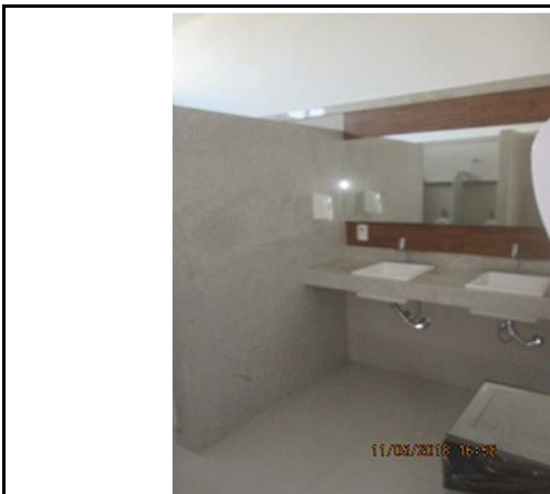
Vista sanitário masculino para clientes.
