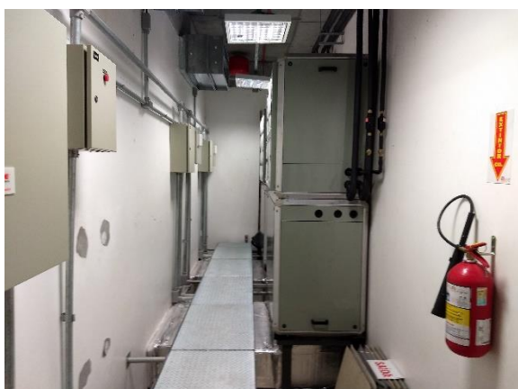
Prédio Adm – Máquinas – 3º Pav
