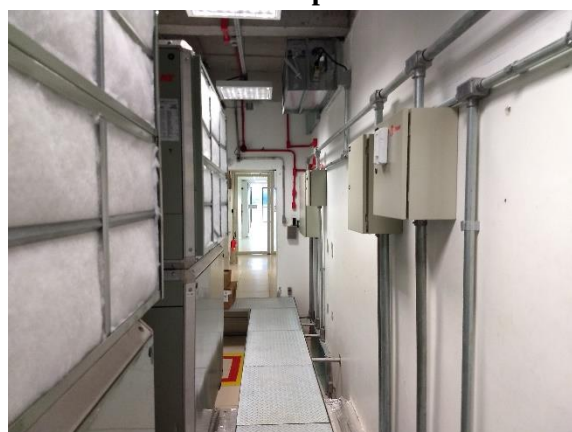
Prédio Adm – Máquinas – 3º Pav
