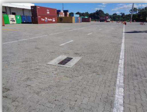
Detalhe de um ponto de drenagem no pátio de contêineres (3ª Fase – Expansão – Área F)
