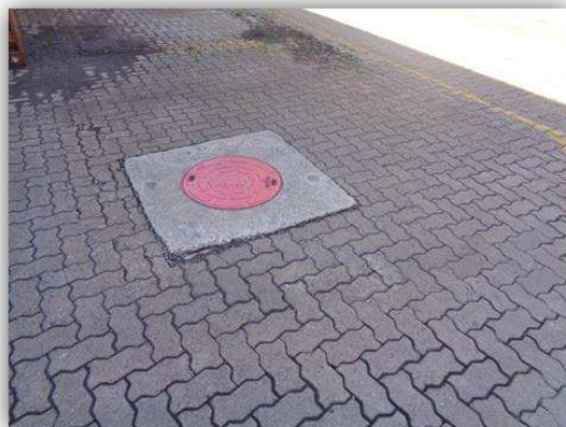
Detalhe de um dos pontos de acesso a instalação do sistema de combate a incêndio no pátio de armazenagem de contêineres (1ª Fase)
