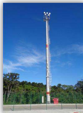
Vista parcial do sistema de iluminação do pátio de armazenagem de contêineres (Área C)
