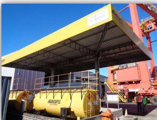
Vista parcial da área do posto de abastecimento (diesel)
