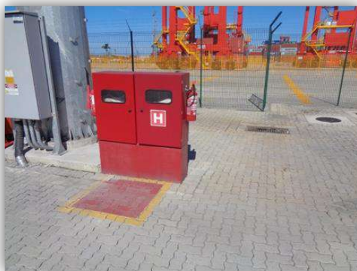
Detalhe de um ponto do sistema de combate à incêndio no pátio de armazenagem de contêineres (3ª Fase – Expansão – Área E)
