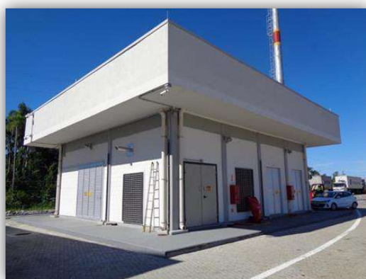
Vista parcial externa da subestação 05 (SE-05)
