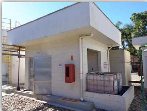
Vista parcial externa da casa de máquinas da estação de tratamento de efluentes (ETE)
