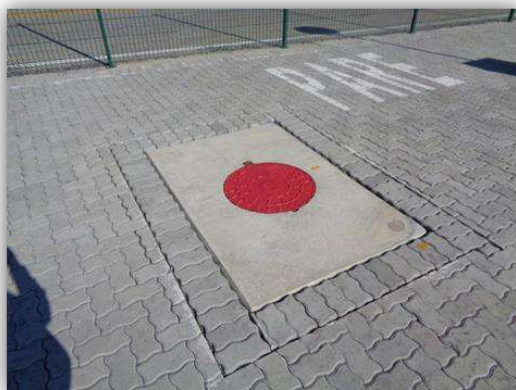
Detalhe de um dos pontos de acesso do combate a incêndio no pátio de armazenagem de contêineres (3ª Fase – Expansão – Área C)
