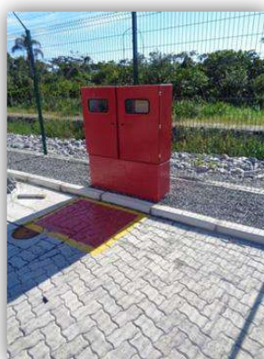
Detalhe de um dos pontos de acesso do combate a incêndio na área de armazenagem de contêineres (3ª Fase – Expansão – Área D)
