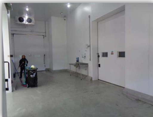
Vista parcial externa da área das câmaras frigoríficas (produtos resfriados / congelados) do novo armazém (3ª Fase de Expansão – Área E)
