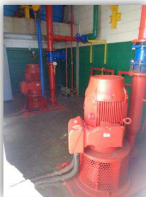
Detalhe interno da área da casa de bombas do sistema de combate a incêndio
