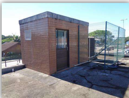
Vista parcial externa do abrigo para o equipamento de refrigeração que atende o refeitório
