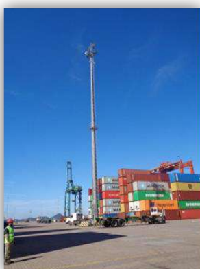
Vista parcial do sistema de iluminação do pátio de armazenagem de contêineres (1ª Fase)
