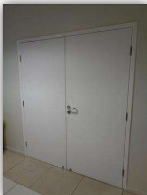
Vista parcial externa da sala de operação (Operação Remota)
