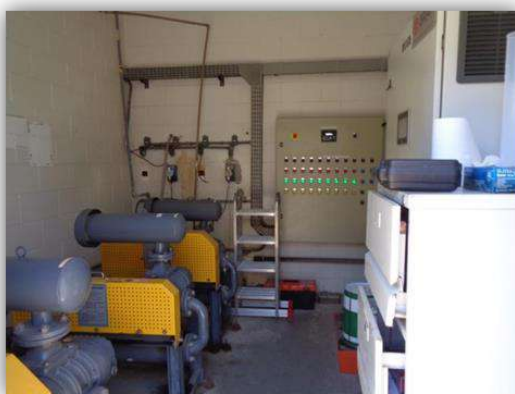
Vista parcial interna da casa de máquinas da estação de tratamento de efluentes (ETE)
