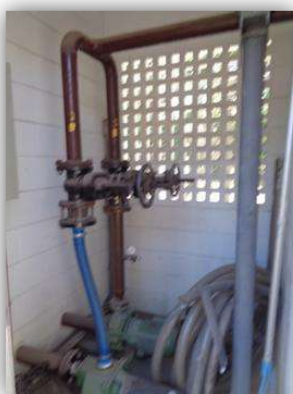
Vista parcial interna da casa de bombas da estação de tratamento de efluentes (ETE)
