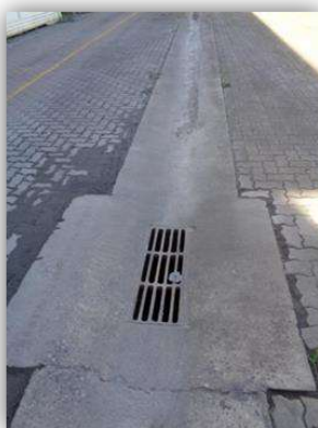
Detalhe de um dos pontos do sistema de drenagem no pátio de armazenagem de contêineres (1ª Fase)
