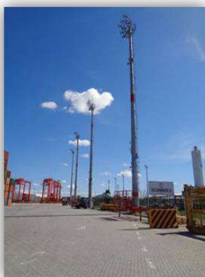
Vista parcial do sistema de iluminação do pátio de armazenagem de contêineres (Áreas A + B)
