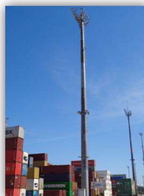
Vista parcial do sistema de iluminação do pátio de armazenagem de contêineres (2ª Fase – Expansão)
