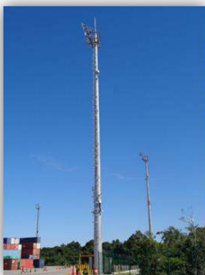
Vista parcial do sistema de iluminação do pátio de armazenagem de contêineres (Área F)
