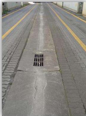
Detalhe de um dos pontos do sistema de drenagem no pátio de armazenagem de contêineres (2ª Fase - Expansão)
