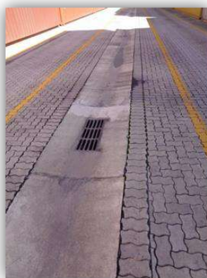
Detalhe de um dos pontos de instalação do sistema de combate a incêndio no pátio de armazenagem de contêineres (3ª Fase – Expansão – Áreas A +B)
