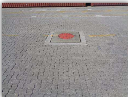
Detalhe do sistema de drenagem no pátio de armazenagem de contêineres (3ª Fase – Expansão – Áreas A + B)
