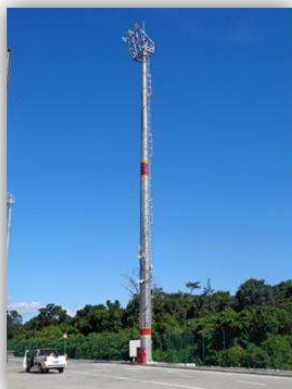
Vista parcial do sistema de iluminação do pátio de armazenagem de contêineres (Área E)
