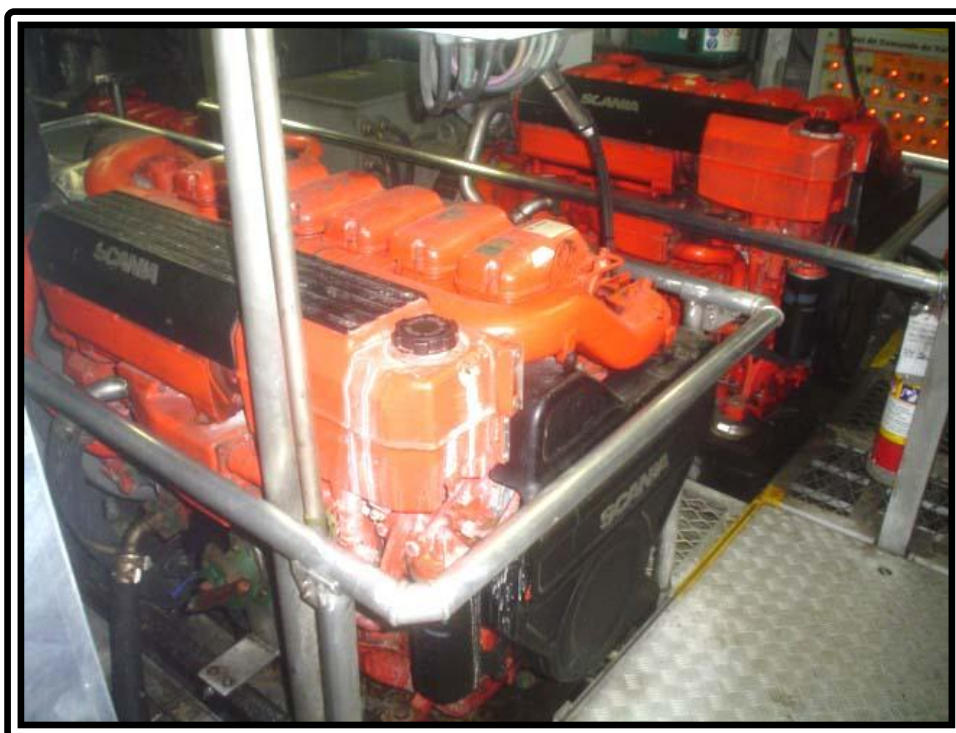
FOTO Nº 40:- PRAÇA DE MÁQUINAS – GRUPOS GERADORES BOMBORDO “LEROY SOMER” POT. 375KW
