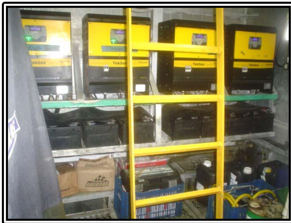
FOTO Nº 37:- CONVÉS INFERIOR – CARREGADORES DE BATERIAS DA MOTORIZAÇÃO
