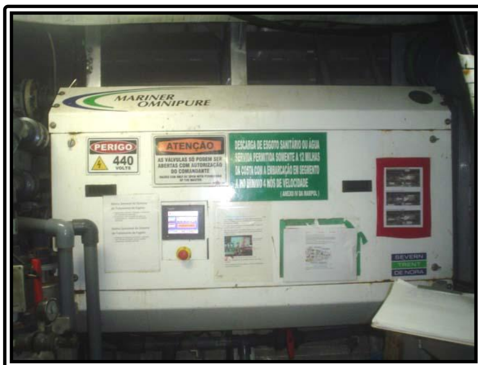
FOTO Nº 35:- CONVÉS INFERIOR – SISTEMA TRATAMENTO DE ESGOTO “DE NORA” MARINER OMNIPURE
