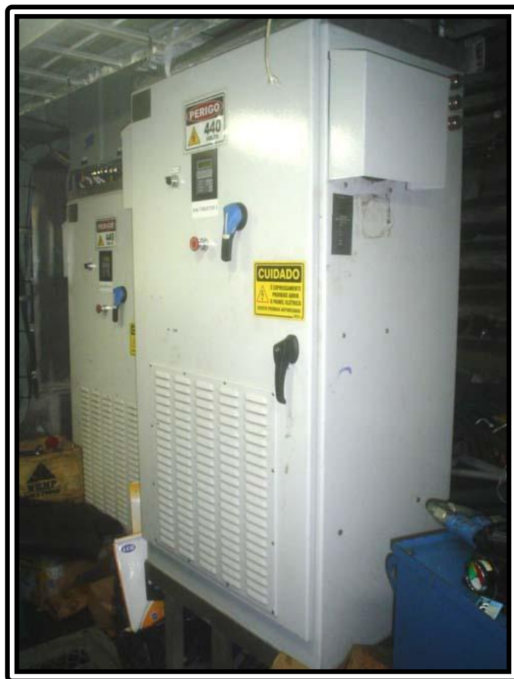
FOTO Nº 32:- CONVÉS INFERIOR – PAINÉIS ELÉTRICOS BOW THRUSTER 1 E 2
