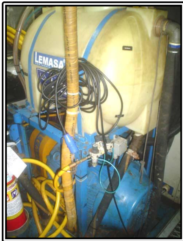
FOTO Nº 38:- PRAÇA DE MÁQUINAS – EQUIPAMENTO DE ULTRA PRESSÃO MARCA “LEMASA”
