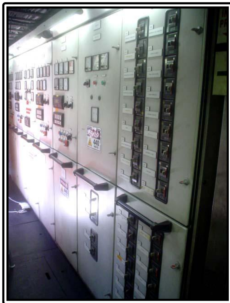
FOTO Nº 43:- PRAÇA DE MÁQUINAS – PAINEL ELÉTRICO E DE COMANDO MOTORES E GERADORES
