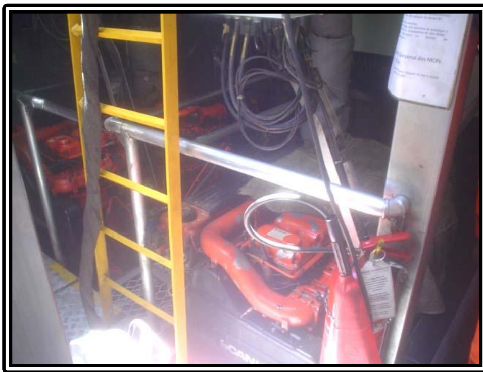
FOTO Nº 42:- PRAÇA DE MÁQUINAS – MOTORES DIESEL MARÍTIMO BORESTE “SCANIA” POT. 550HP
