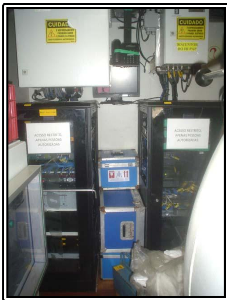
FOTO Nº 29:- CONVÉS PRINCIPAL – CENTRAL TELECOMUNICAÇÃO DA EMBARCAÇÃO SDSV (INTERNET)
