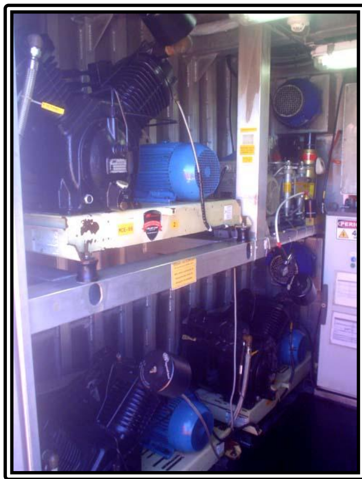
FOTO Nº 49:- CONVÉS SUPERIOR – MERGULHO – COMPRESSORES DE BAIXA E ALTA PRESSÃO DE O 2
