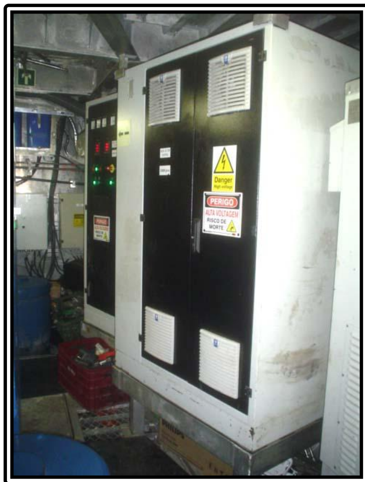
FOTO Nº 31:- CONVÉS INFERIOR – PAINÉIS ELÉTRICOS ROV “ATOM”
