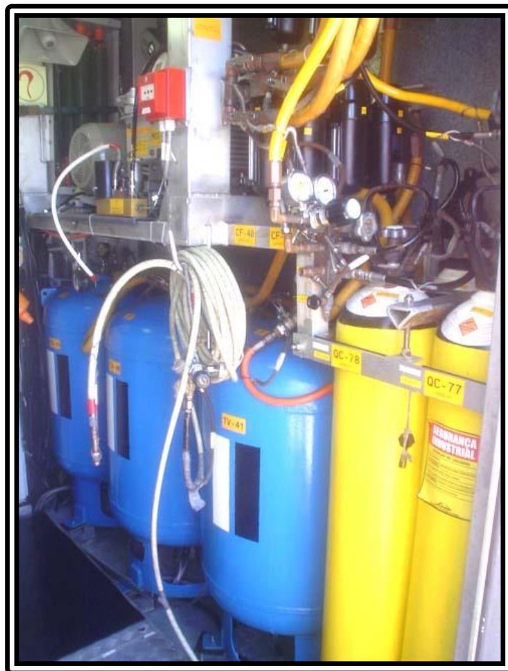
FOTO Nº 50:- CONVÉS SUPERIOR – MERGULHO – TANQUES DE VOLUME E CILINDROS DE O 2
