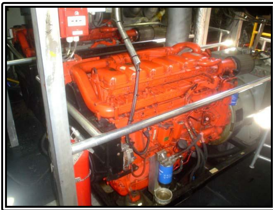
FOTO Nº 39:- PRAÇA DE MÁQUINAS – GRUPOS GERADORES BORESTE “LEROY SOMER” POT. 375KW
