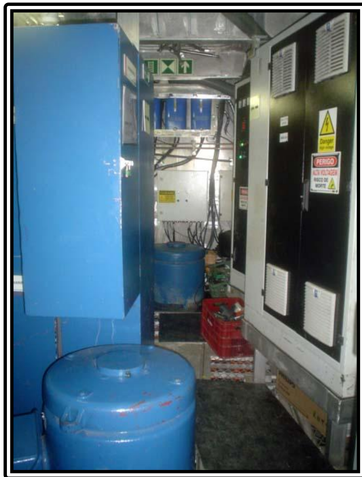
FOTO Nº 30:- CONVÉS INFERIOR – VISTA GERAL DA SALA DO BOW THRUSTER
