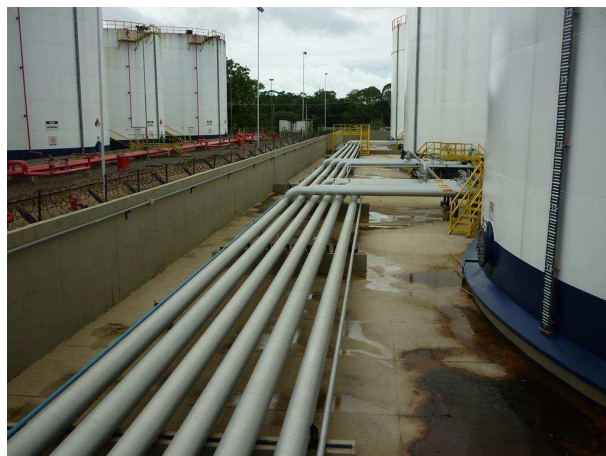
Tubulação de combustíveis da Bacia 2
