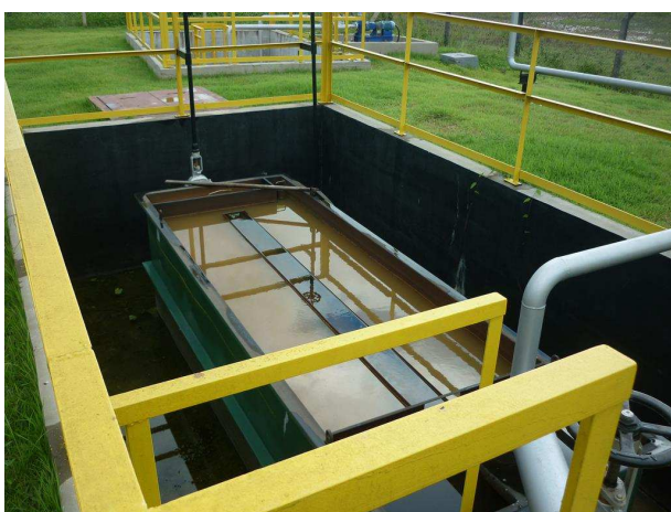
Caixa separadora “C”
