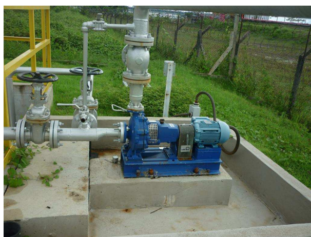
Caixa separadora “C”
