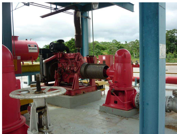
Motor bomba de combate de incêndio
