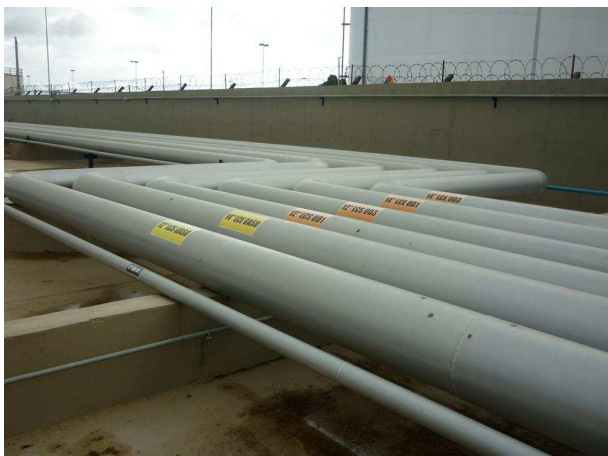
Tubulação de combustíveis da Bacia 2
