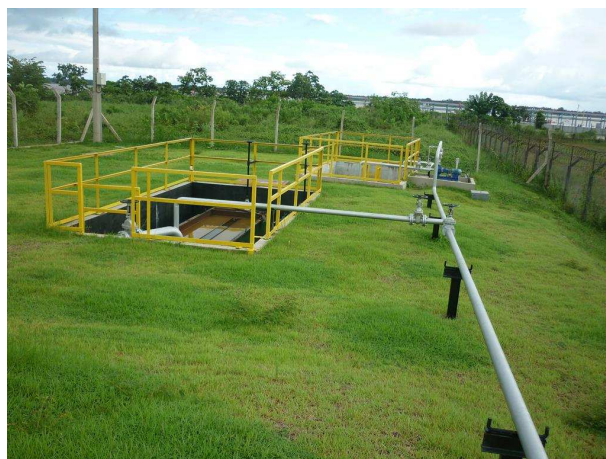
Caixa separadora “C”
