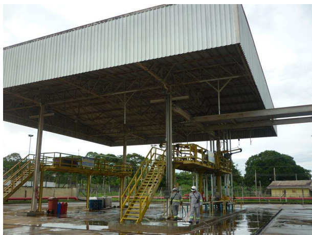
Plataforma de Carregamento
