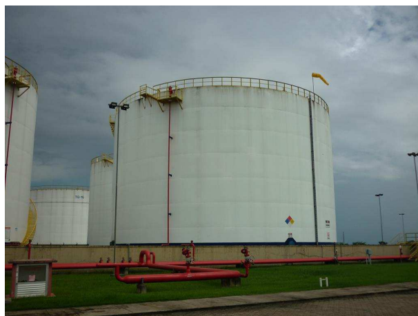
Bacia 1 – Contenção e abrigo de Tanques
