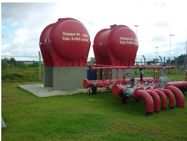
Tanque de Líquido Gerador de Espuma (LGE)
