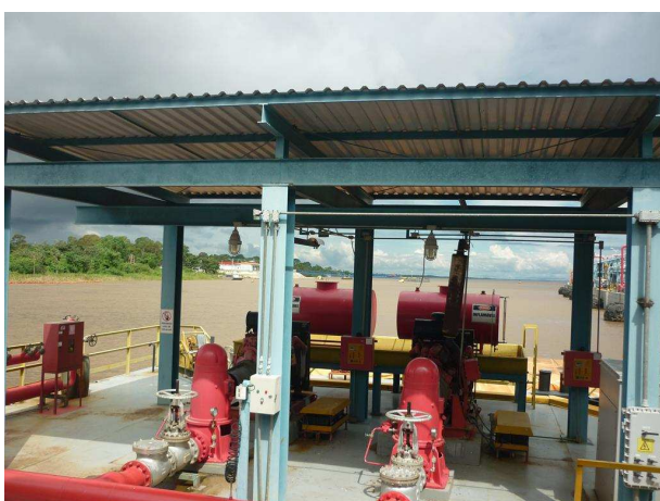
Embarcação de combate de incêndio do Cais flutuante
