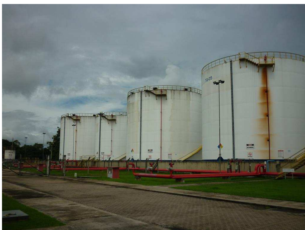
Bacia 1 – Contenção e abrigo de Tanques
