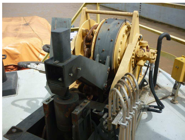
Sistema de ancoramento da embarcação
