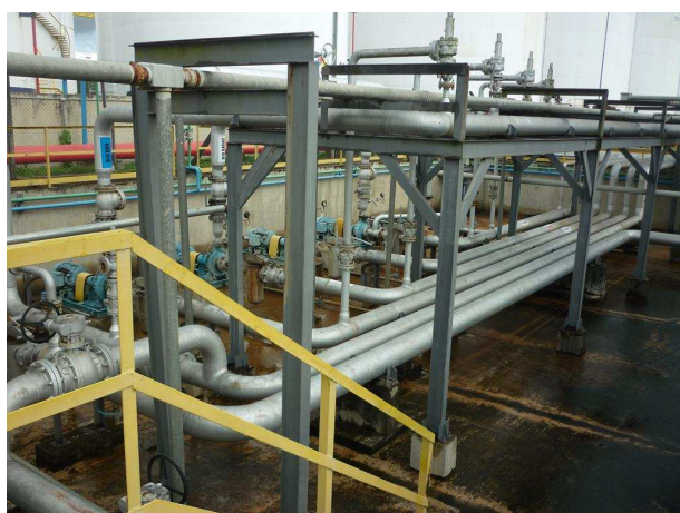
Área de Bombas B
