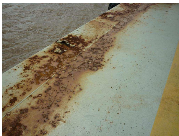
Vista do Cais Flutuante – oxidação do piso por ação natural e atrito de ancoradores na superfície
