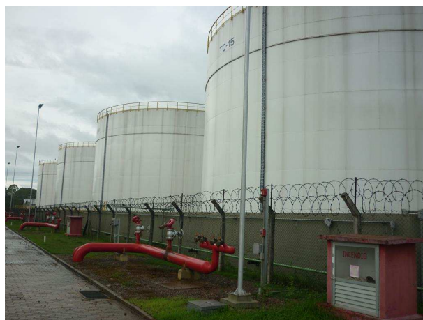
Bacia 1 – Contenção e abrigo de Tanques
