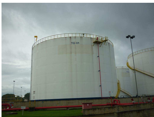
Bacia 1 – Contenção e abrigo de Tanques
