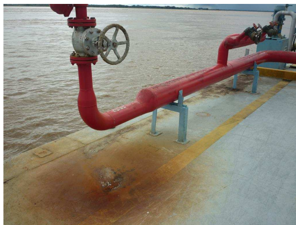
Vista do Cais Flutuante e oxidação no piso causado por atrito e ou ação de produto reagente
