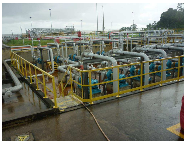
Área de bombas “A”
