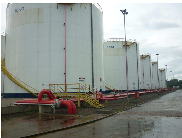
Vista lateral da Bacia 1 – Rede de incêndio
