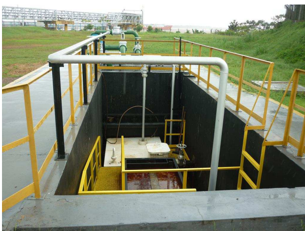
Caixa separadora “A”
