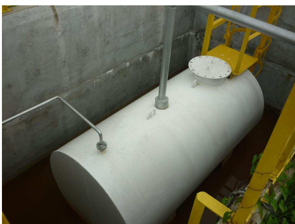
Caixa separadora “C”
