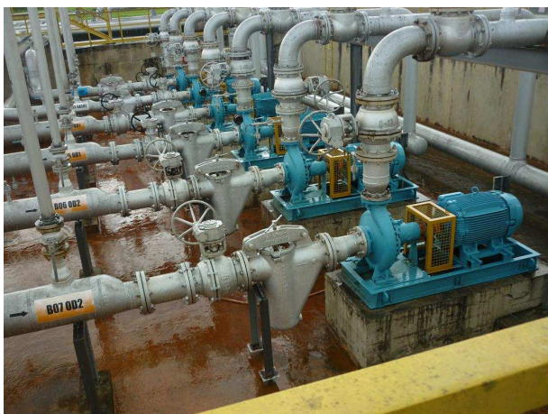
Área de bombas “A”
