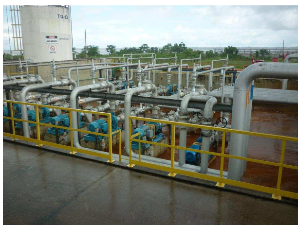
Área de bombas “A”
