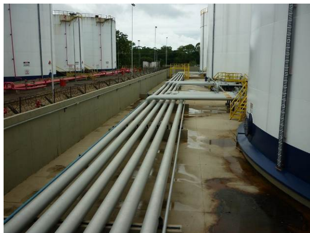
Tubulação de combustíveis da Bacia 2
