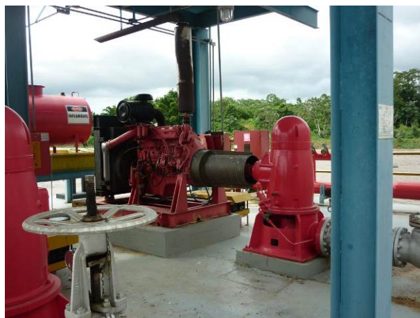
Motor bomba de combate de incêndio
