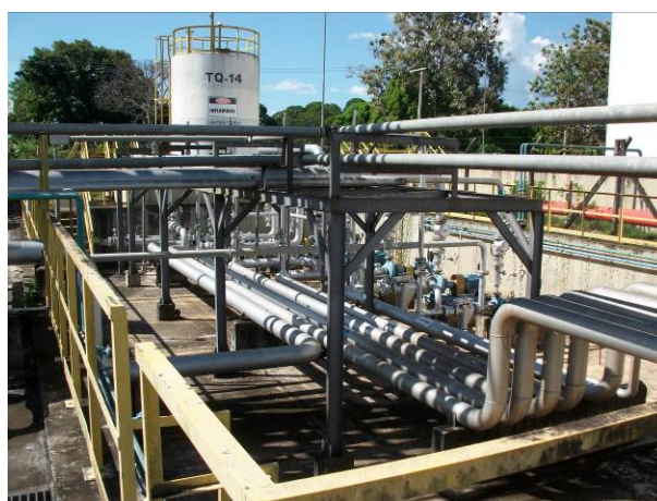
Bombas do sistema de distribuição de combustível
