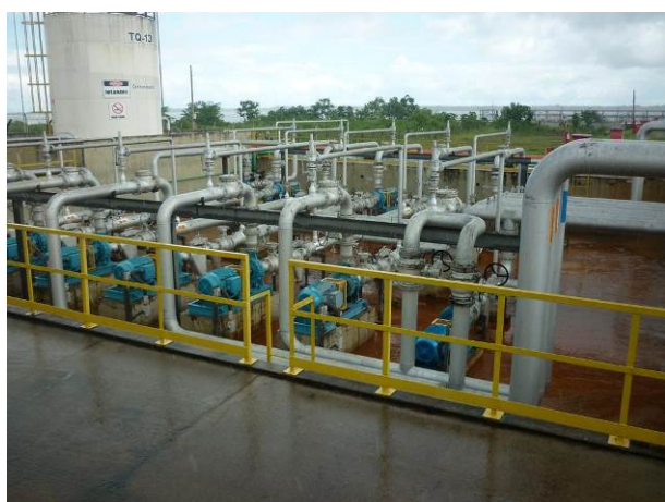
Área de bombas “A”
