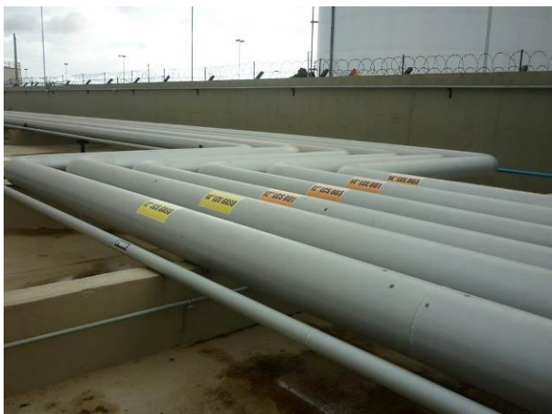
Tubulação de combustíveis da Bacia 2
