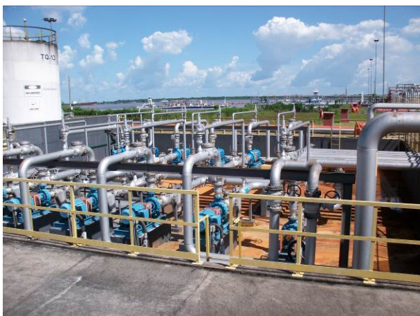
Bomba do sistema de distribuição de combustível
