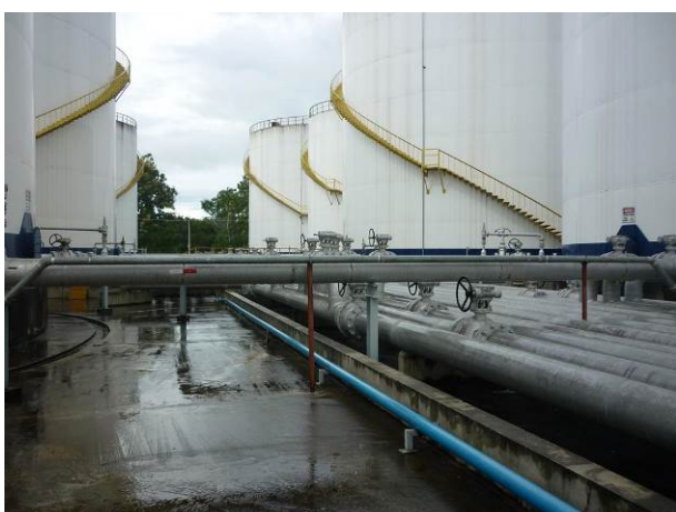
Vista dos dutos de combustíveis na bacia 1
