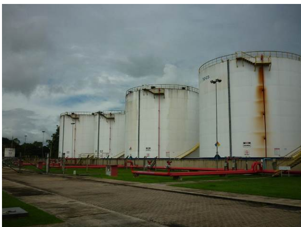
Bacia 1 – Contenção e abrigo de Tanques
