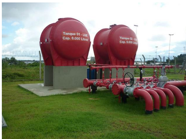
Tanque de Líquido Gerador de Espuma (LGE)
