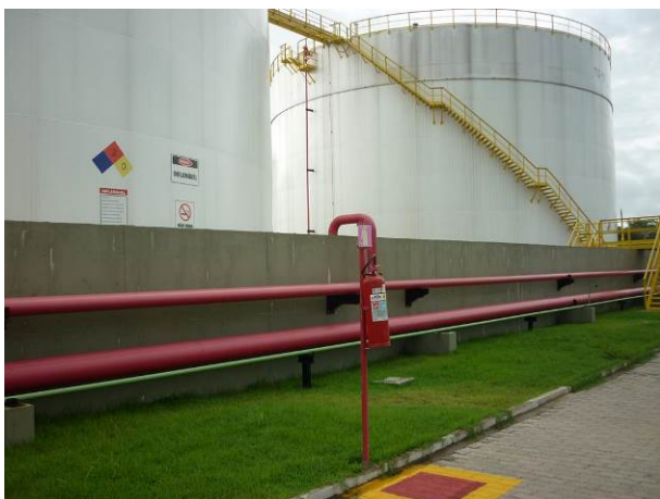
Vista da Bacia 2 e Tanques
