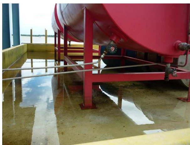
caixa coletora do tanque de combustível do motor-bomba de combate a incêndio
