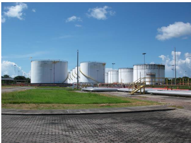
Vista geral dos tanques de armazenamento de combustível
