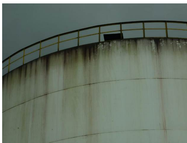
Tanque 14 - Contaminados B
