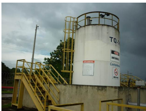
Tanque 14 - Contaminados B
