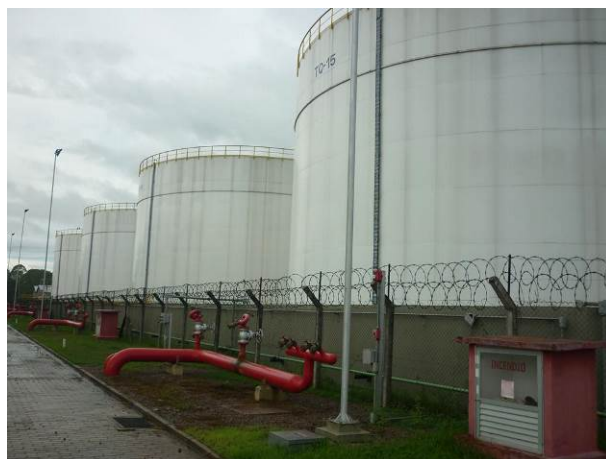
Bacia 1 – Contenção e abrigo de Tanques
