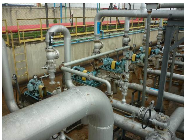
Área de Bombas B
