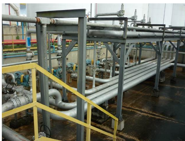
Área de Bombas B
