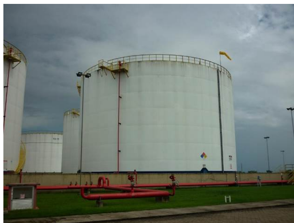
Bacia 1 – Contenção e abrigo de Tanques
