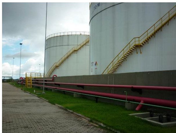
Vista da Bacia 2 e Tanques
