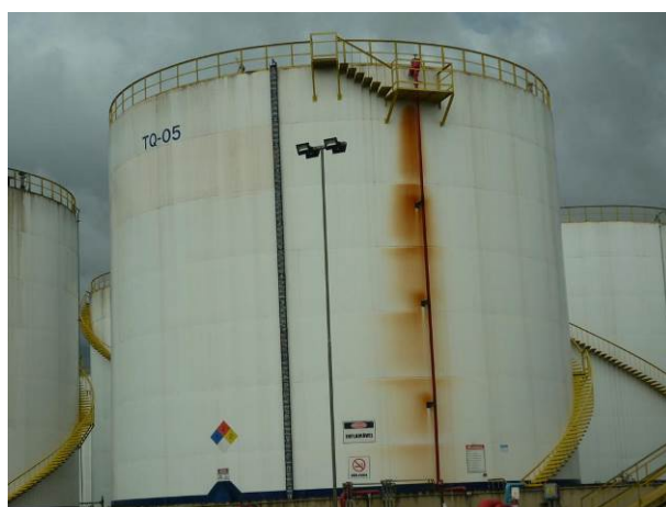
Bacia 1 – Tanque 05 enfase oxidação pintura por derramamento de produto reagente.
