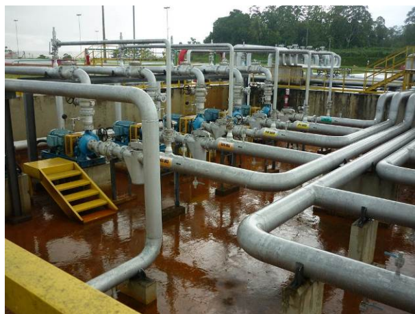
Área de bombas “A”
