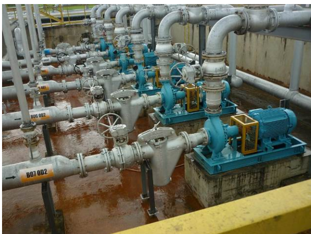
Área de bombas “A”
