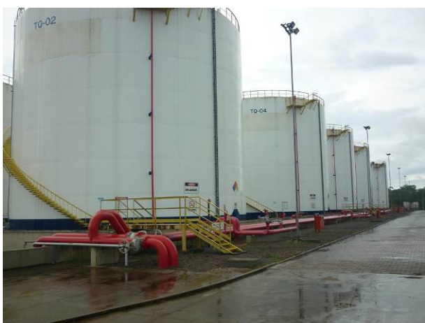
Vista lateral da Bacia 1 – Rede de incêndio
