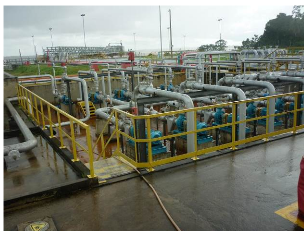
Área de bombas “A”
