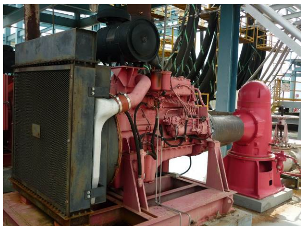
Motor bomba de combate de incêndio
