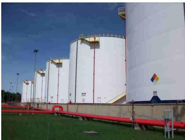
Bacia 1 – Contenção e abrigo de Tanques
