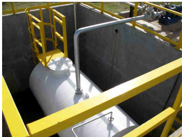
Caixa separadora "C"
