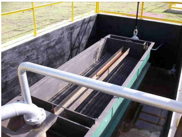
Caixa separadora "C"
