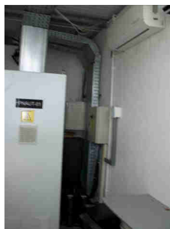
Quadros de comando e telemetria
