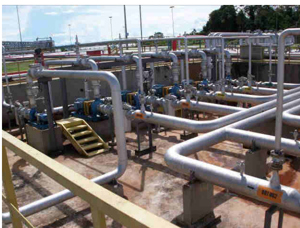
Área de bombas "A"
