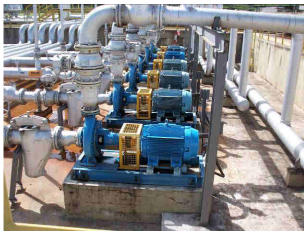
Área de bombas "A"
