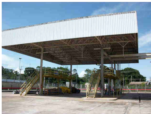
Plataforma de Carregamento
