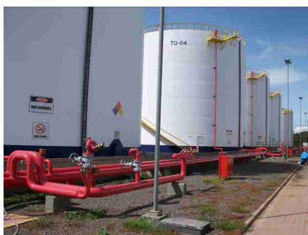
Vista lateral da Bacia 1 – Rede de incêndio
