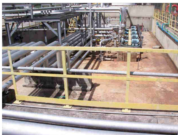
Área de Bombas B
