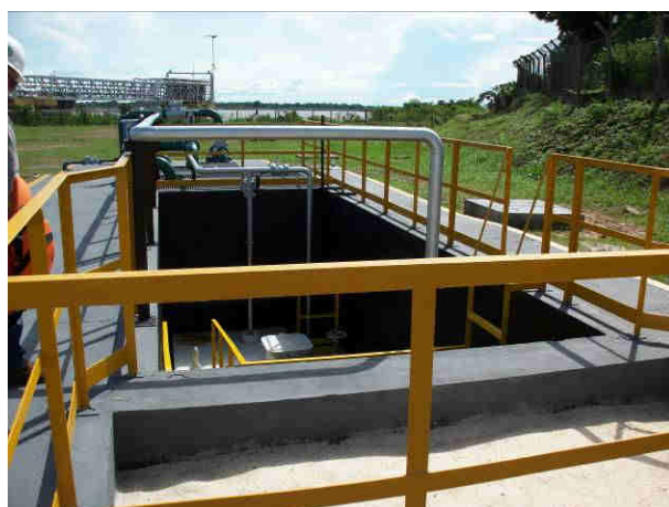
Caixa separadora "A"
