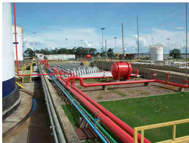
Dutos e sistema de combate de incêndio
