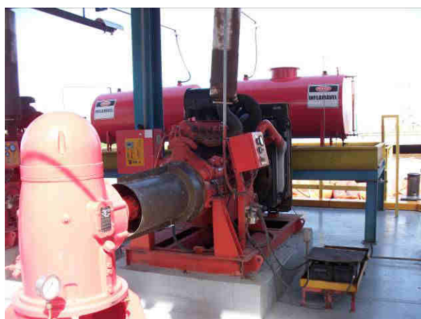
Motor bomba de combate de incêndio
