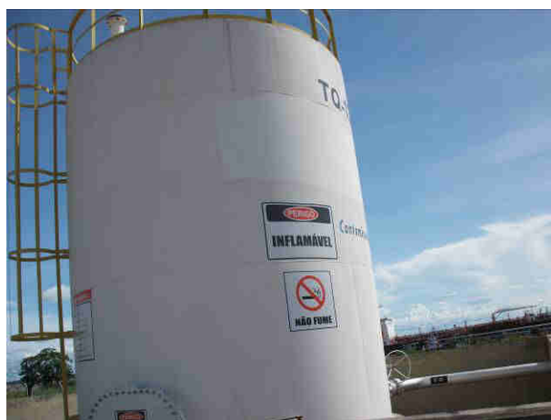
Tanque de contaminados A
