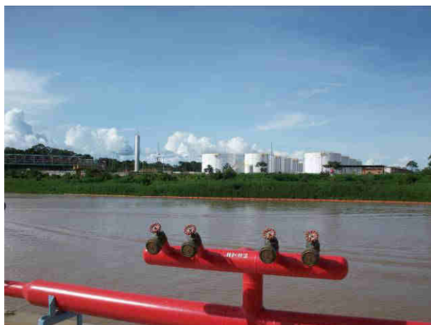
Sistema de hidrantes do cais
