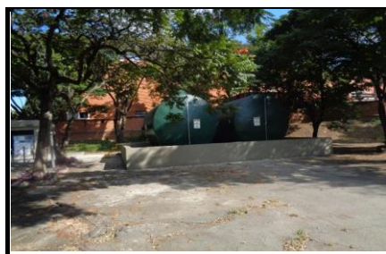
Detalhe reservatórios de tratamentos
