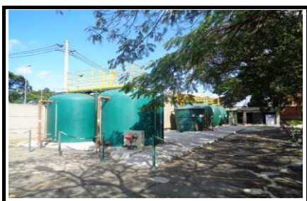
Detalhe reservatórios de tratamentos
