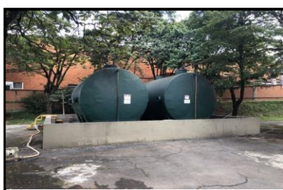
Detalhe reservatórios de tratamento
