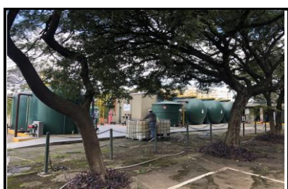
Reservatórios de tratamento
