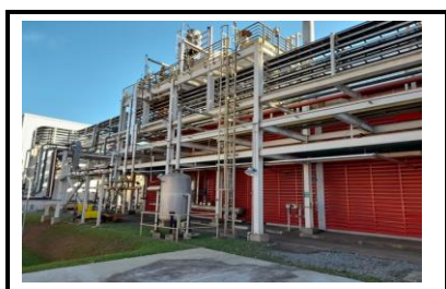
Vista casa caldeiras
