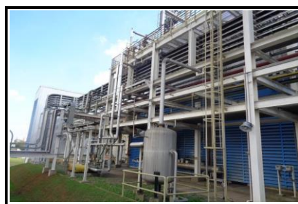
Casa da caldeira
