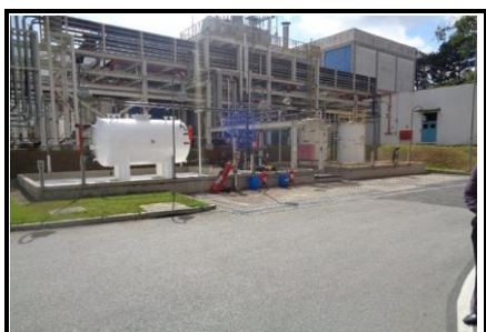
Contenções dos reservatórios
