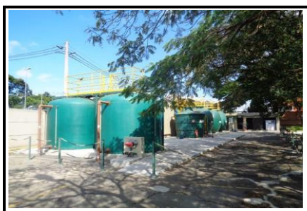
Detalhe reservatórios de tratamentos
