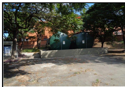
Detalhe reservatórios de tratamentos
