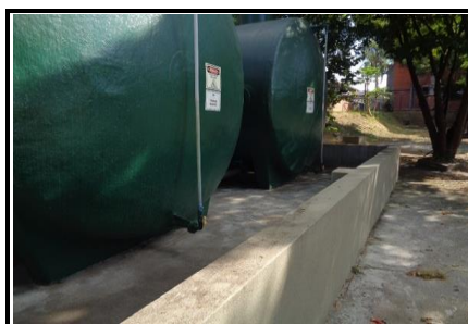
Contenções dos reservatórios
