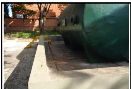
Contenções dos reservatórios
