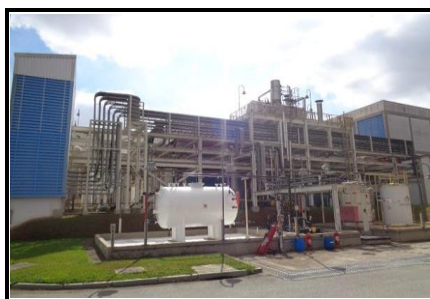
Contenções dos reservatórios
