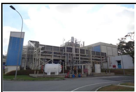
Casa da caldeira
